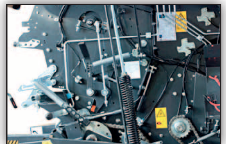
Tuberías hidráulicas metálicas.
